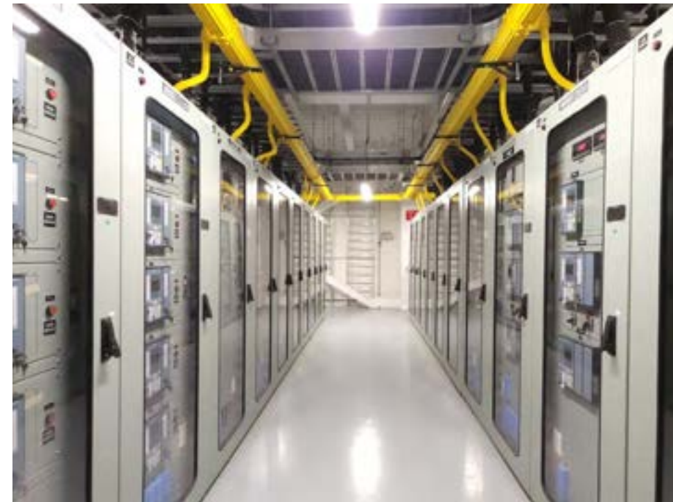
El proyecto Metro-Energía contempló la modernización de los sistemas
